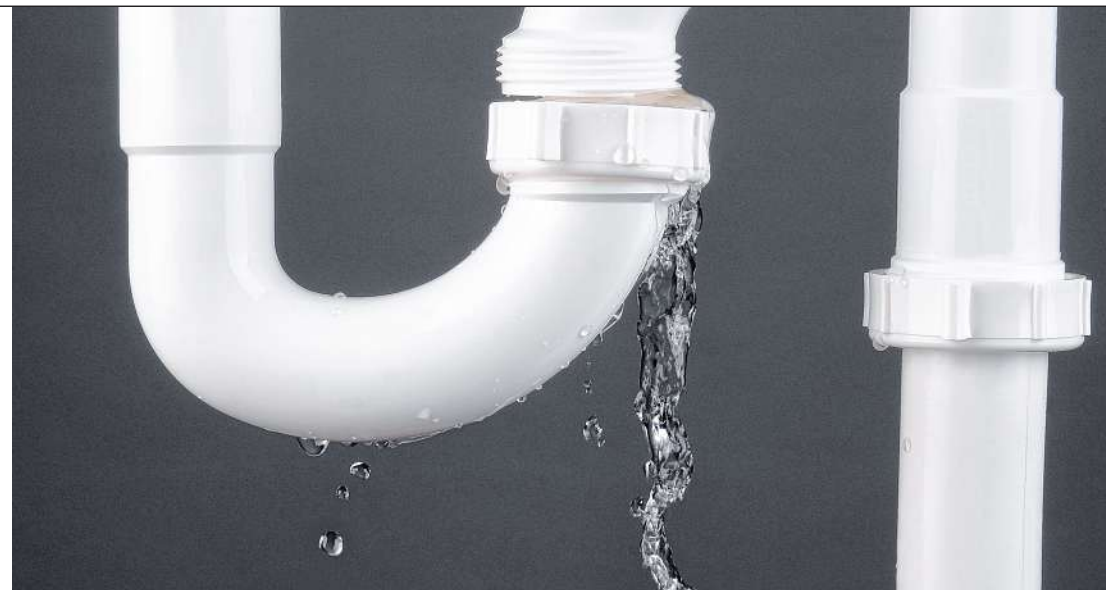
Rohrbrüche gelten als ernste Schäden am Haus – die Kosten werden geteilt
